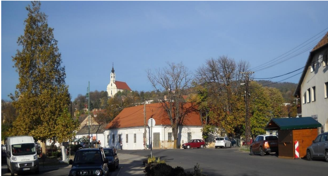
A volt Nékám-patika épülete felújított tetővel várja az alapok víztelenítését és kulturális szerepének betöltését.
